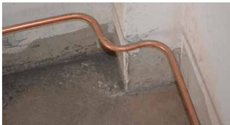
Conductor de puesta a tierra equipotencial
