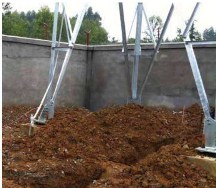
Puesta a tierra de torre de telecomunicaciones
