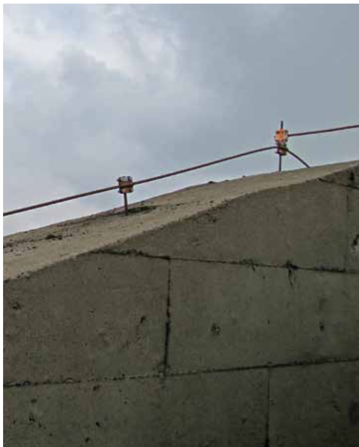
Protección contra descargas atmosféricas
