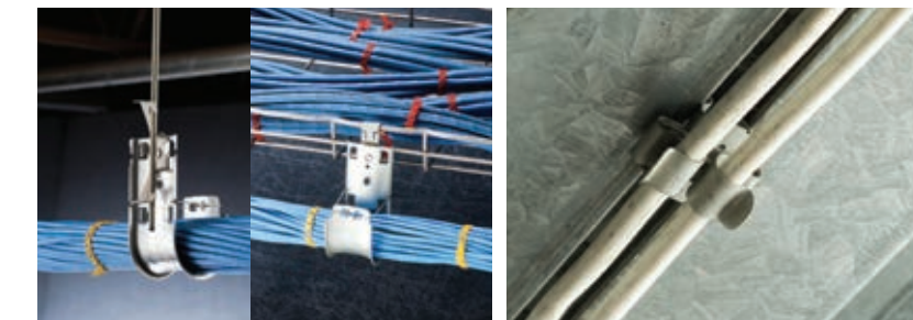
Daten-/Elektrokabel Kabel/Kabelschutzrohr abgehängt von Verbundstahldecken
