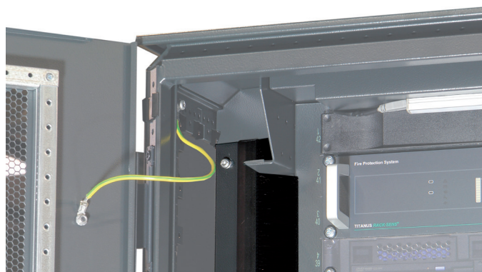
Utilisation optimale de l'espace disponible dans la baie serveur
